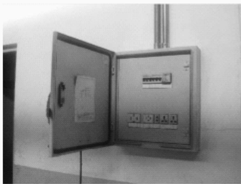
图 1-6 各工位配电箱
