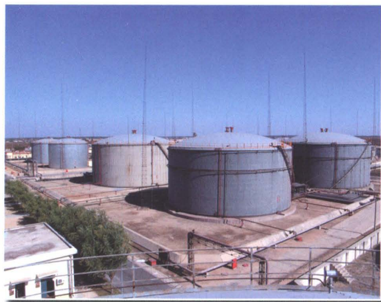
公司施工的欢三联污水处理站
