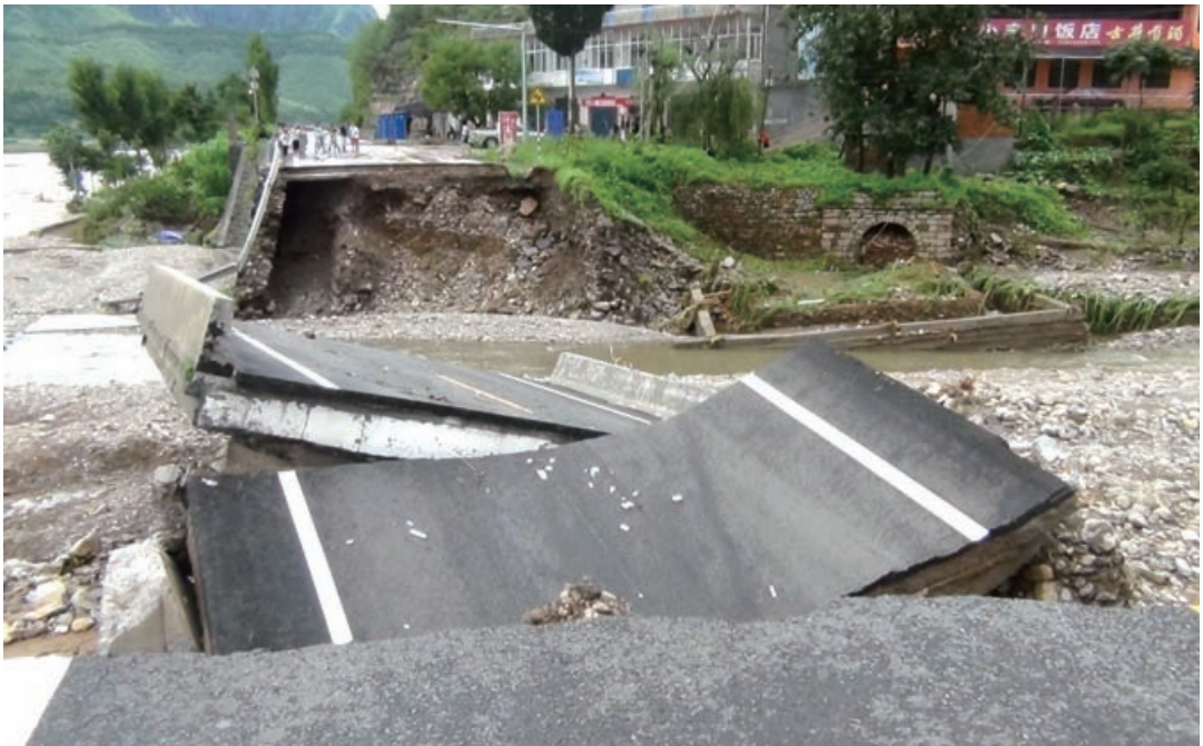
被洪水冲毁的涉县小峰口大桥。
