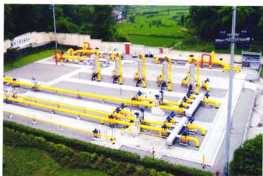
天然气集中输配气站
