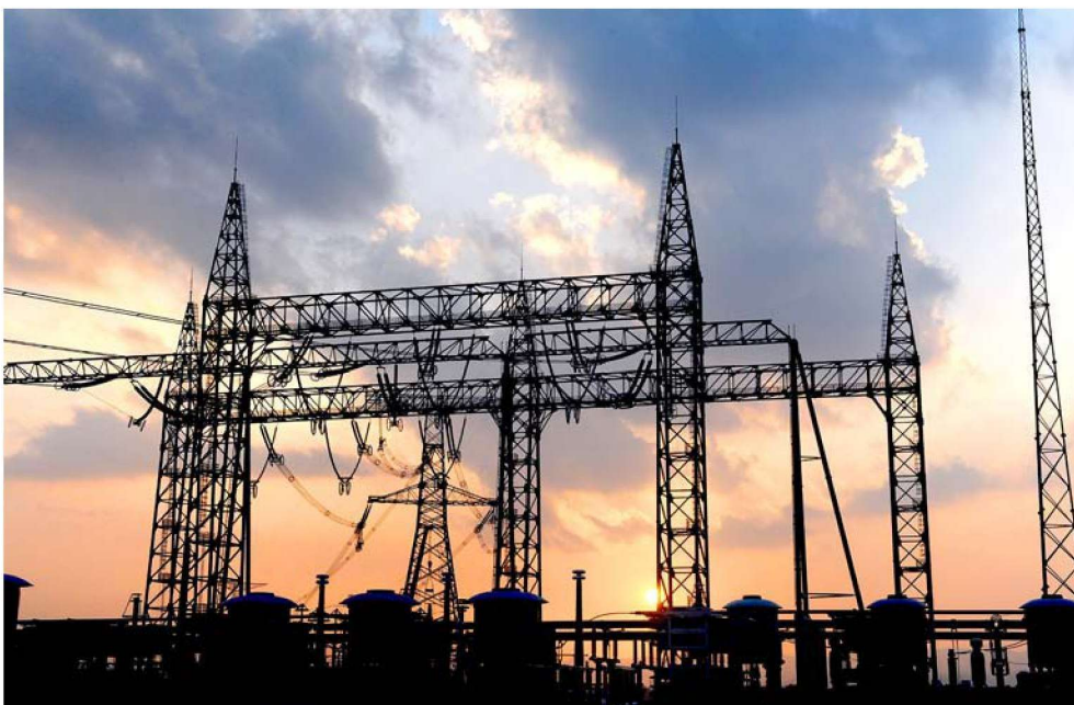
我国首座 1000 千伏特高压长治变电站
