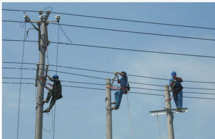
◀ 三多供电所现场工作人员
