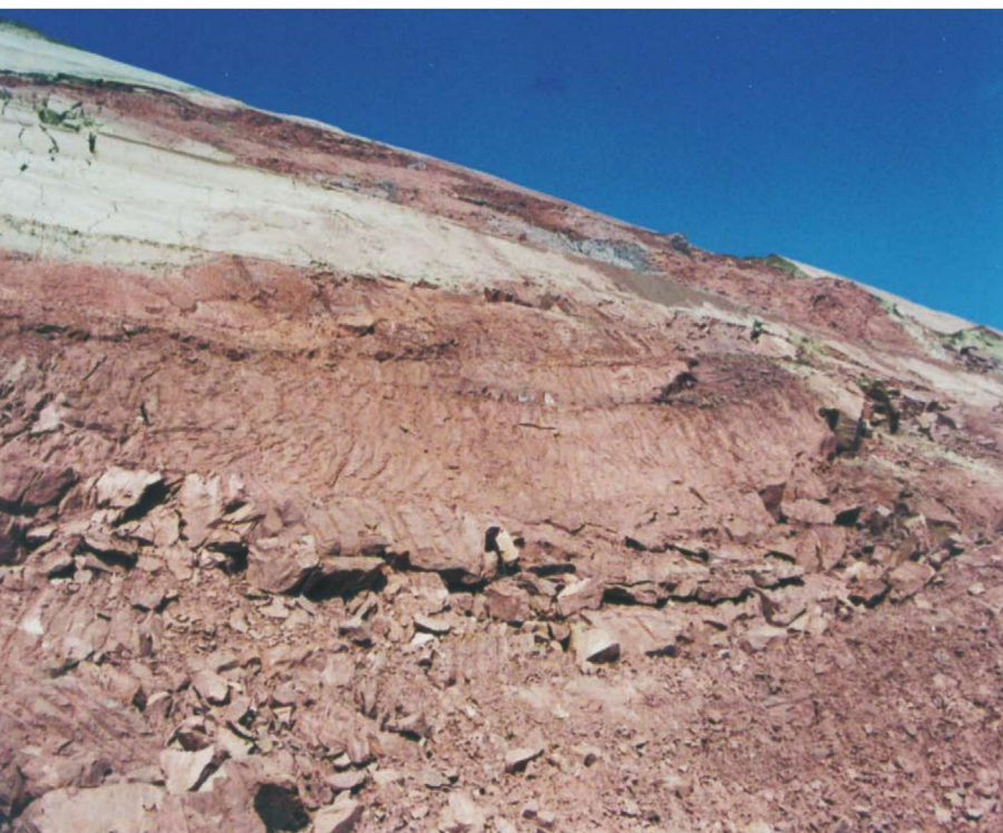
兰州—临洮高速公路黄土—泥岩边坡滑坡剪出口及变形破坏情况
