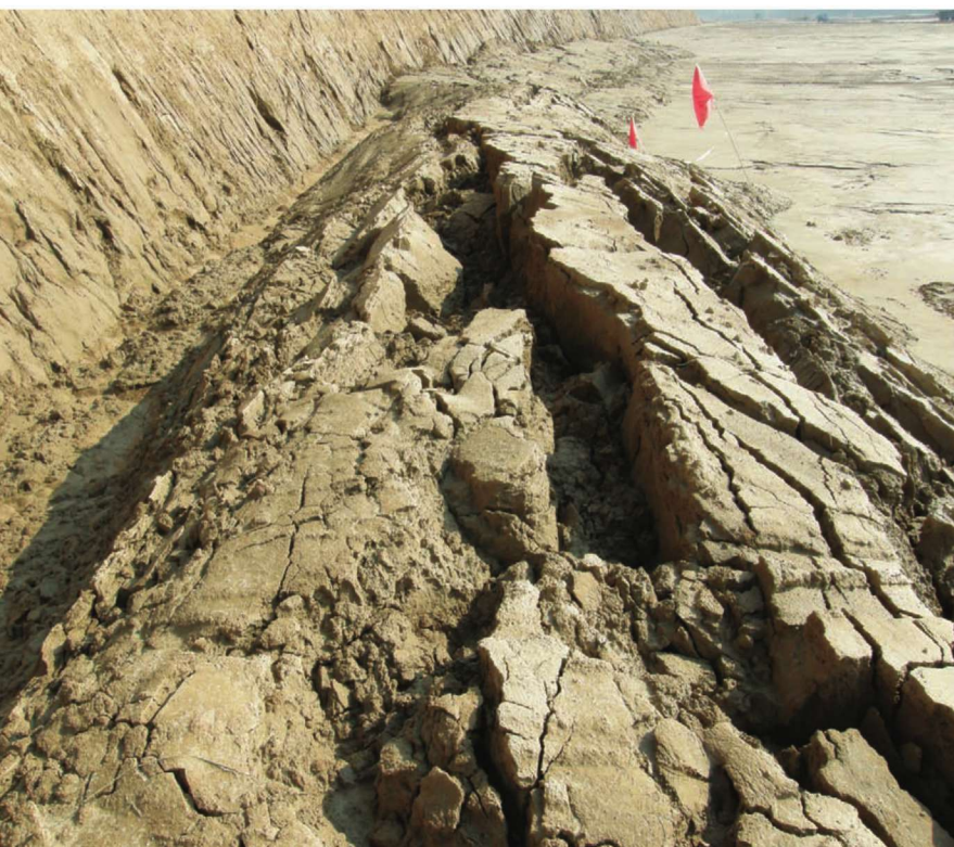
滑坡前缘鼓胀裂缝与鼓起（华池开发区）
