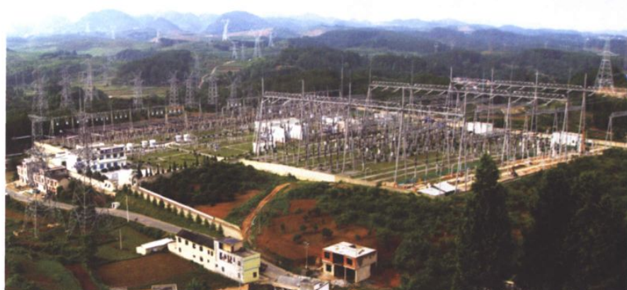
卓岭500千伏变电
