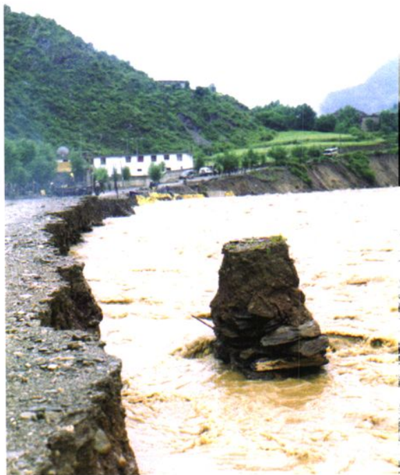
“7·11”特大洪灾多处公路路基毁坏
