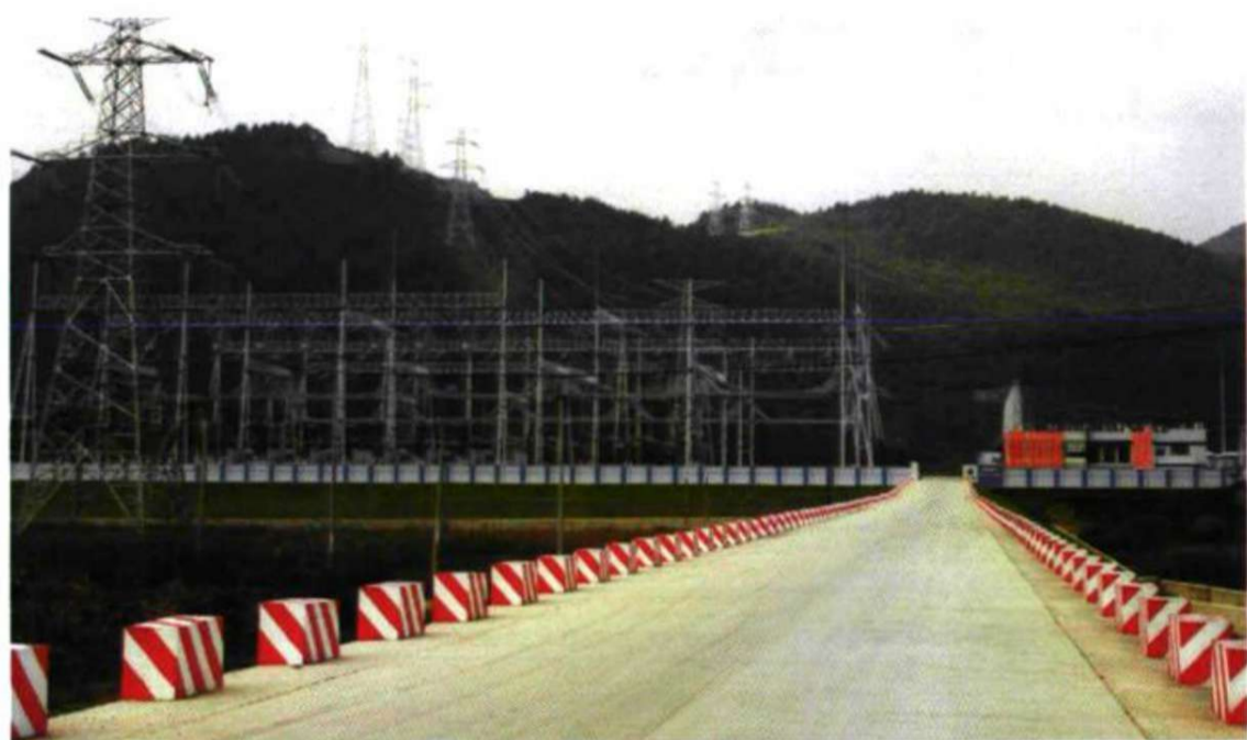
华中电网重点工程—— 500千伏恩施输变电站 (2007年摄)
