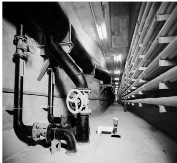
综合管廊排水系统
