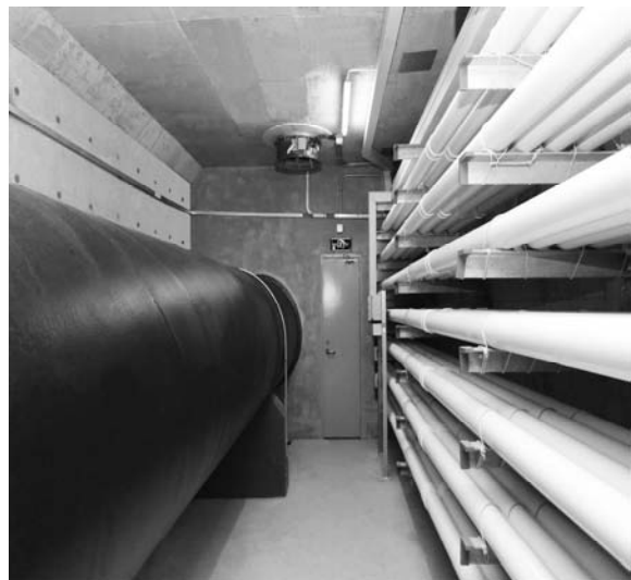
综合管廊防火门
