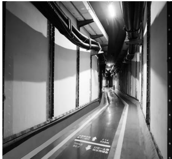
环岛东路中段电力舱
