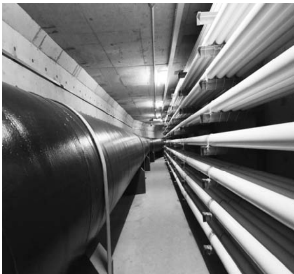
综合管廊大直径管道
