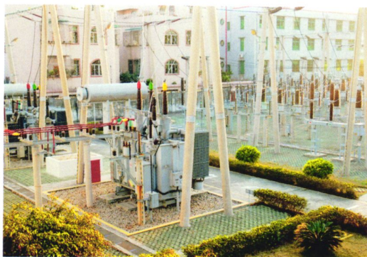
110 千伏澄海变电站（曾建一摄）
