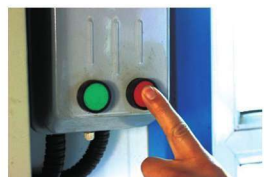
图 1.14 关闭排风设备
