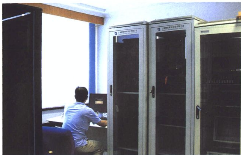
海盐县国土资源局 信息中心机房
