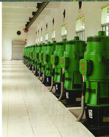
图为更新后的机房和设备
