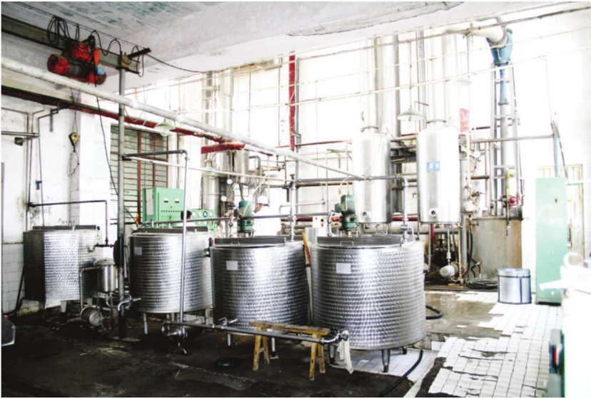
天和乳业有限公司生产线
