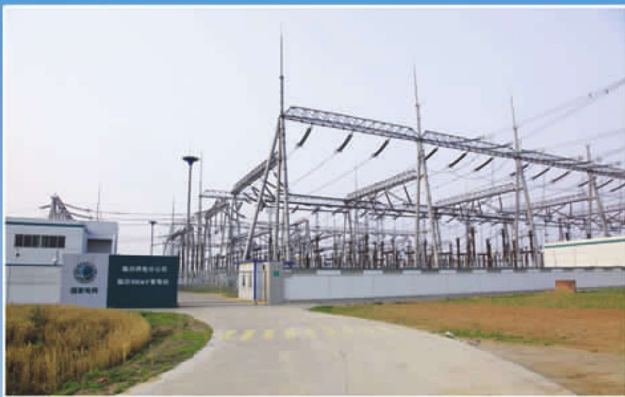
500kV临汾变电站
