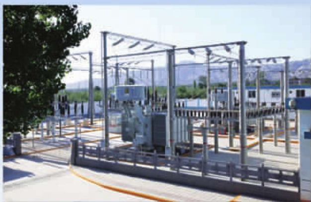
110kV杨谈变电站
