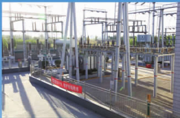
110kV曲沃变电站
