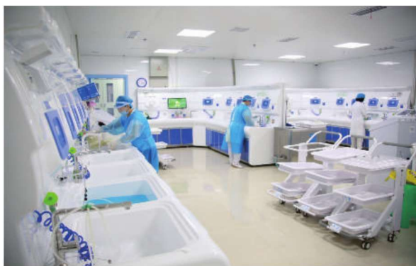
内镜中心消毒设备
