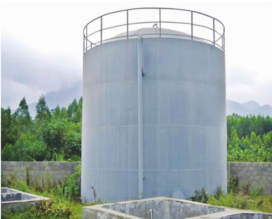
钢板焊制厌氧消化器（广西贵港）
