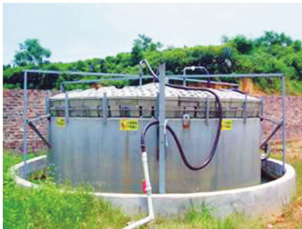
变容式湿式储气柜（广西陆川）
