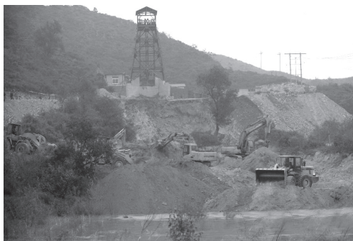
后坡塌陷事故现场 新华社 王晓 摄
