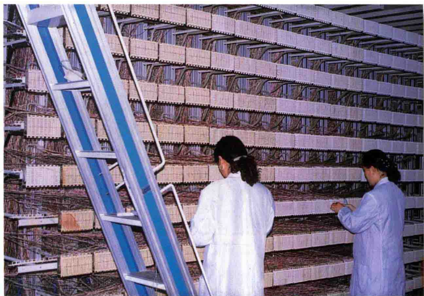
▲程控电话配线室
