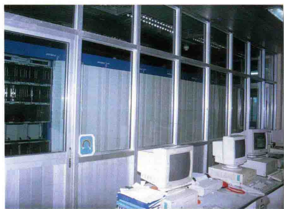
▲九十年代的程控电话交换机房
