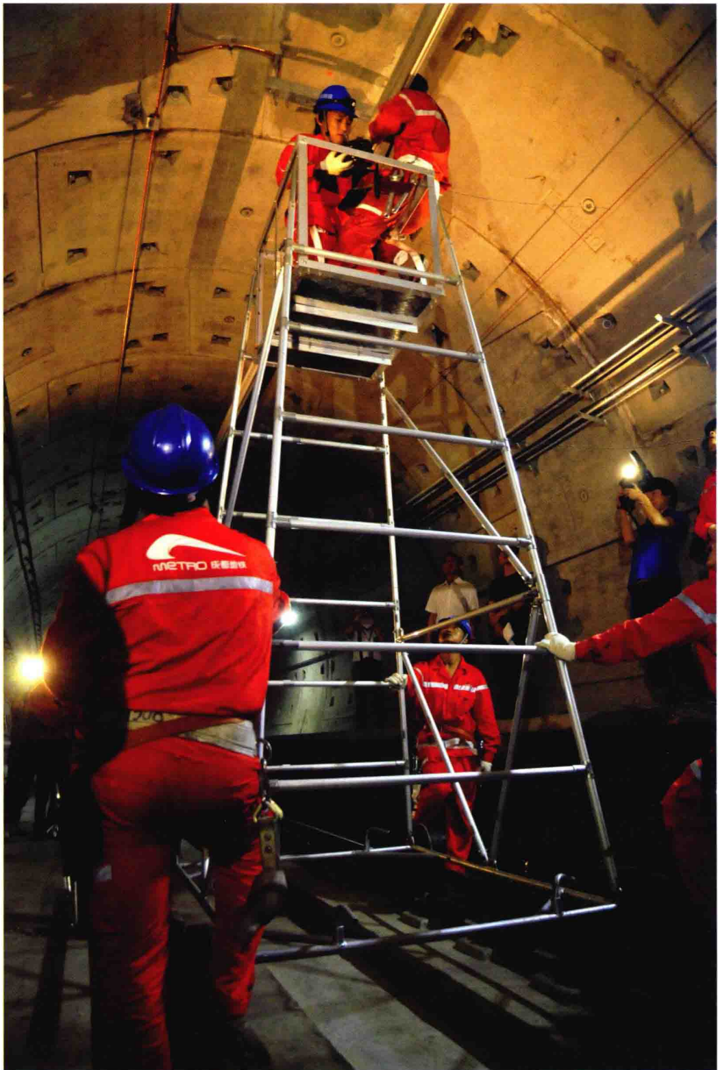
二号线西延线供电故障应急处置综合演练
