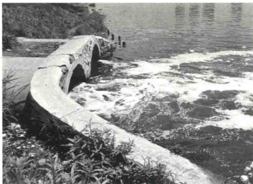
图 1-2-8 暗管排污口（敷设深度较大）
