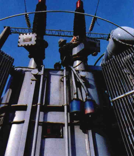
襄渝线牵引变电所
