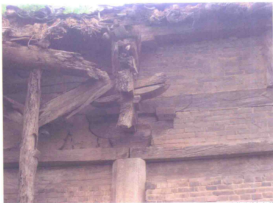
彩图 9 木构件糟朽断裂
