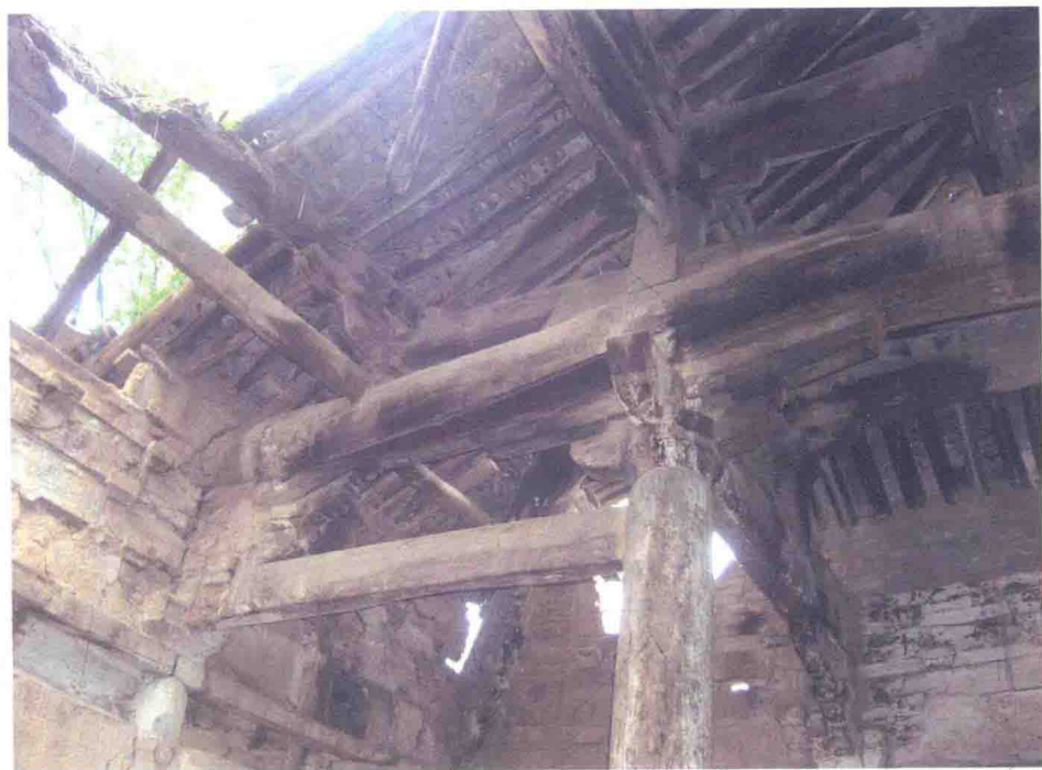
彩图 7 大殿后檐瓦顶坍塌现状
