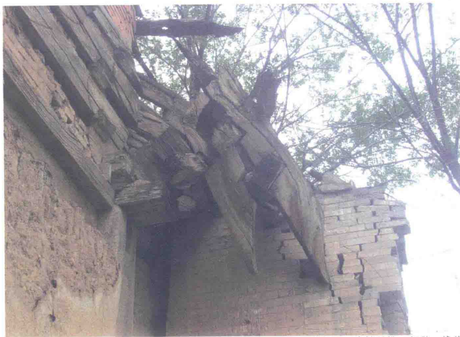
彩图 8 斗拱脱榫、断裂、掉落
