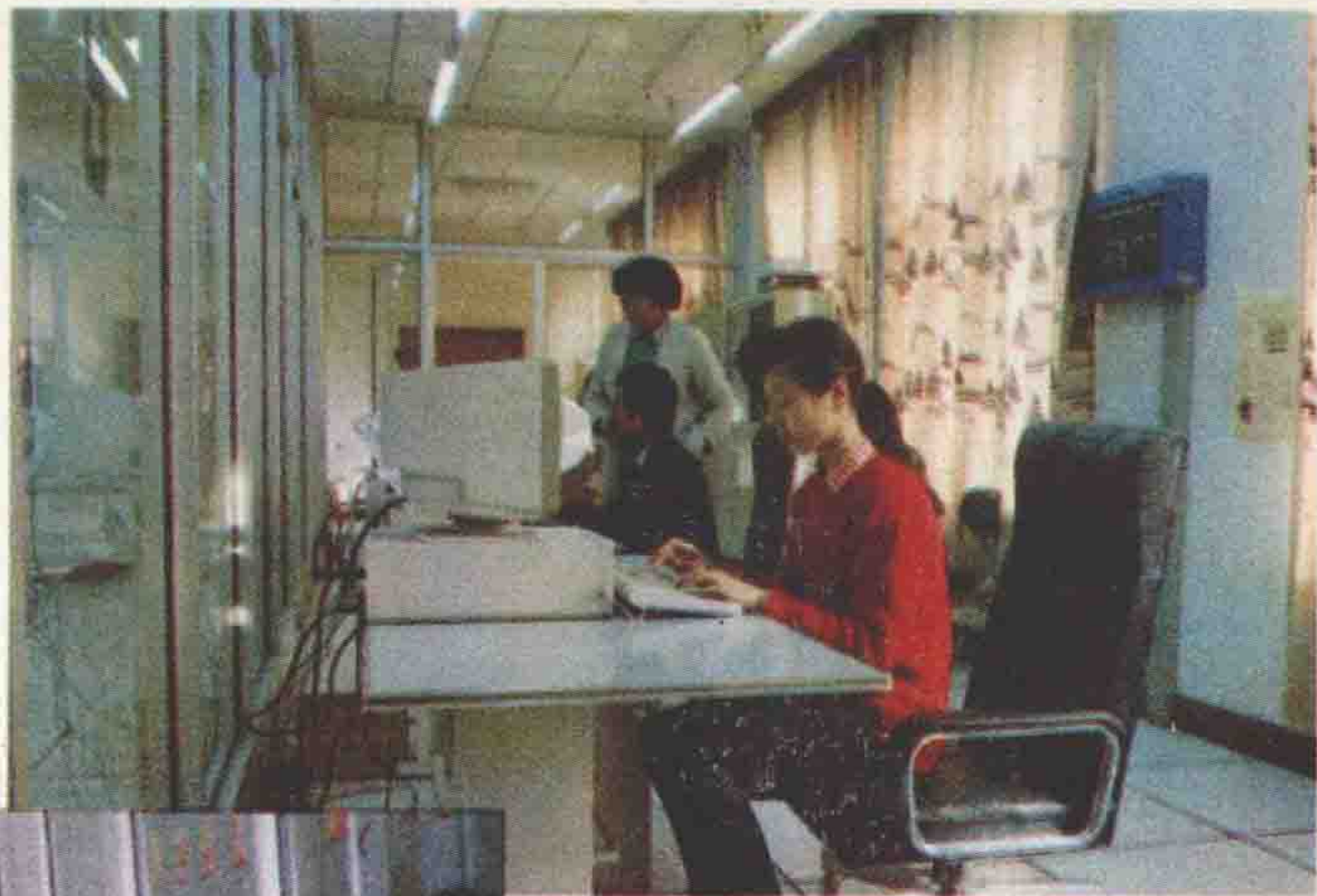
顺义电信局程控机房
