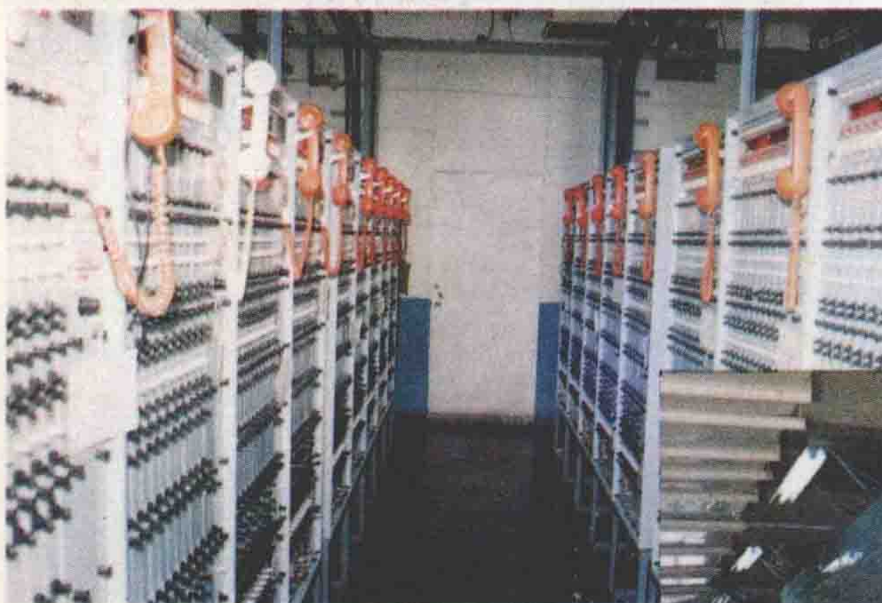
顺义电信局载波机房
