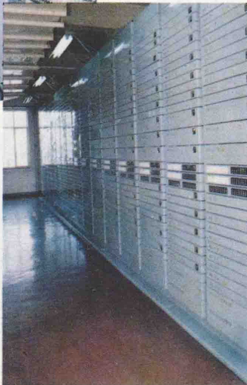
顺义电信局纵横交换机房
