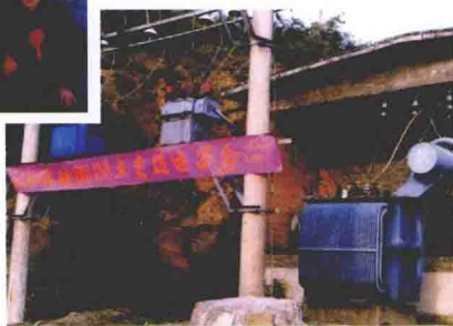
沁新煤矿第一台变压器
