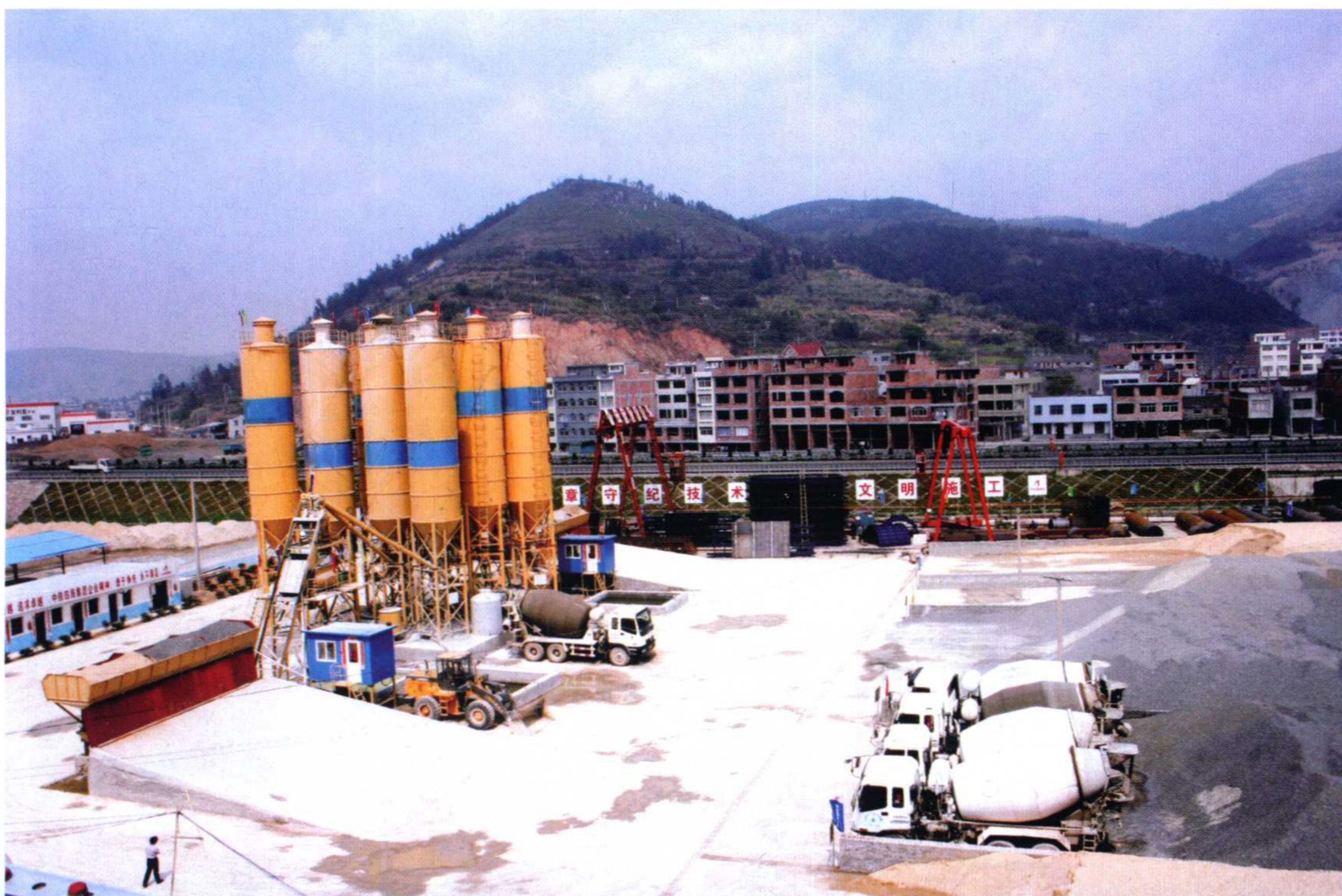
中铁四局拌和站
