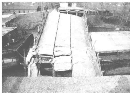
图1-10 盐城跨河大桥船撞事故
