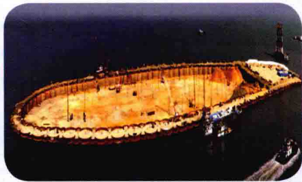
图 9 海上构筑物自动监测技术 （港珠澳大桥西人工岛）
