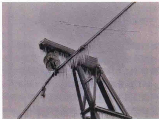
图 1-16 冰灾期间地线结冰情况
