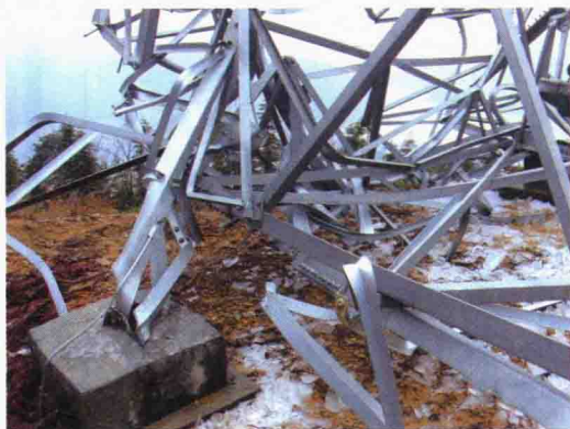
图 1-15 田上线 222 号铁塔倒塔情况
