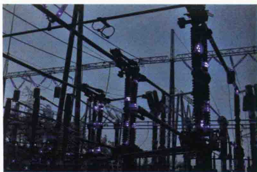
图 1-9 2008 年冰灾期间变电设备外绝缘放电闪络
