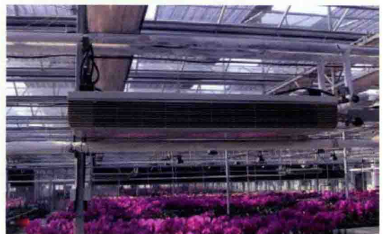
图 9-8 温室电加热设备
