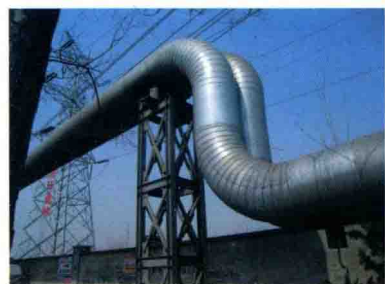
图 73 过门管道支架
