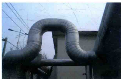
图 7 上伸缩绝热管
