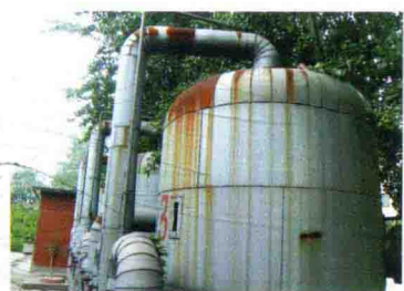
图 90 绝热后的贮水罐
