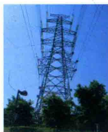
图 4 220kV 高压线架
