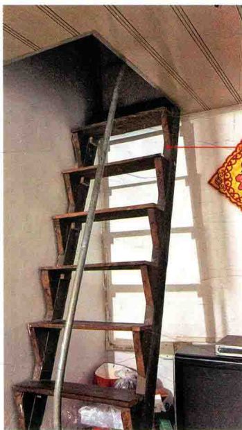
陡峭的楼梯十分危险
