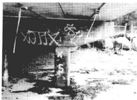
图 1-9 Short beach creek 桥柱开裂情况
