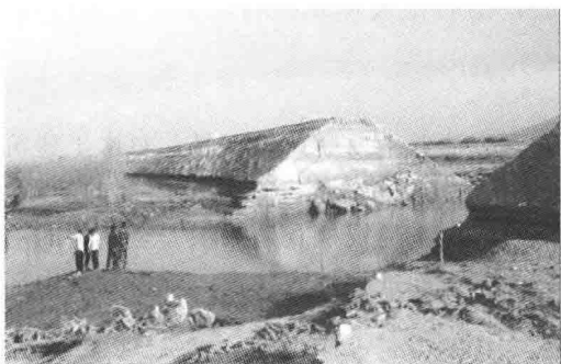
某小型水库垮坝
