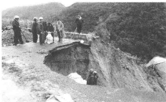
某库区山体滑坡
