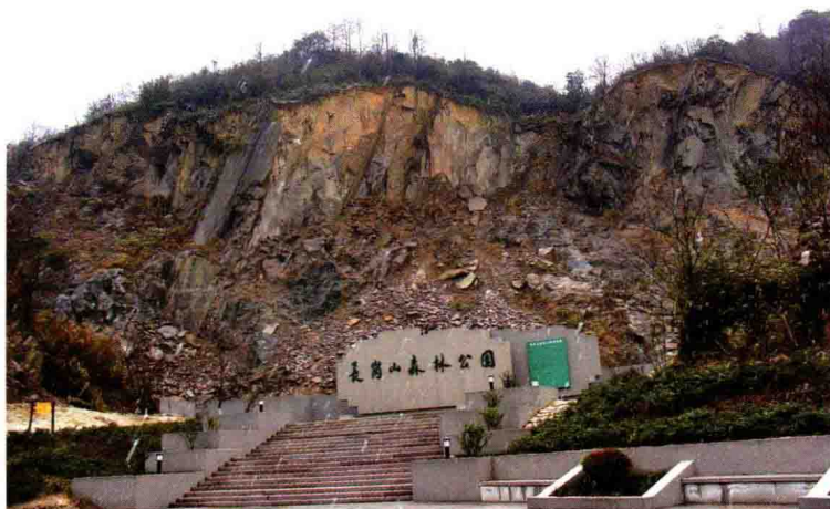
▲ 位于森林公园入口处的采石场原貌，治理前的宕口破败不堪，坡面不稳，有落石
