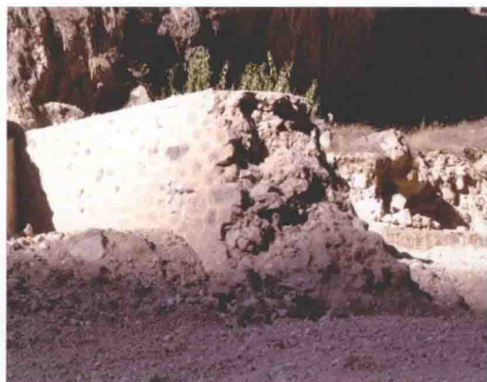
(a)泥石流引起的溃坝
