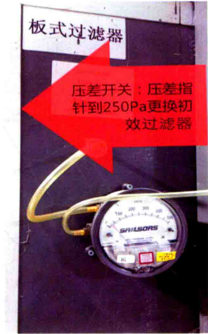
图6-8 压差开关表在中央空调器风箱初级段上的应用（84页）
