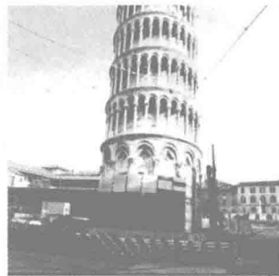
图 1-2 正在纠偏中的 比萨斜塔局部
