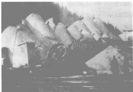
图 1-4 纽约某水泥仓库的地基破坏事故
