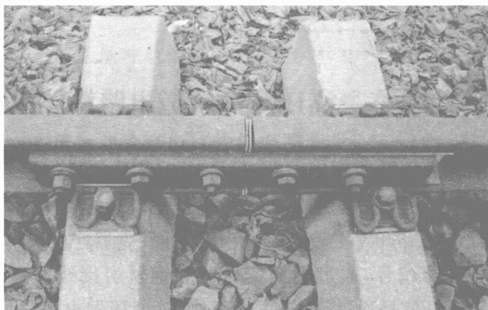
图 1-1 钢轨长期不过车而严重锈蚀
