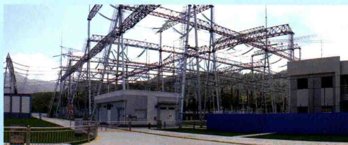
500 千伏梅州变电站
