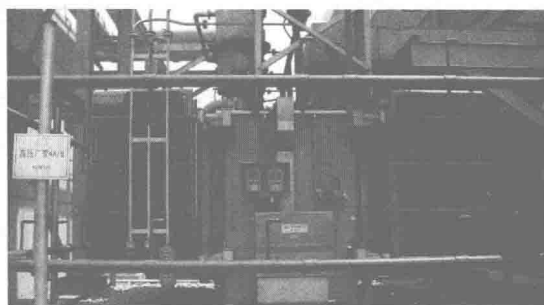
图 1-4 上海阿海法 50/30-30MVA 分裂式 高压厂用变压器
