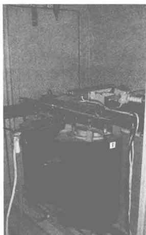
图 1-7 发电机中性点接地变压器
