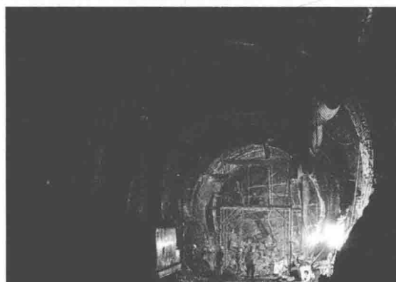
(a) 隧洞塌方
