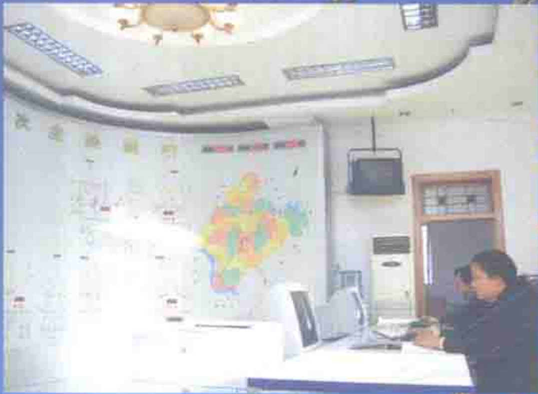
电力调度中心
