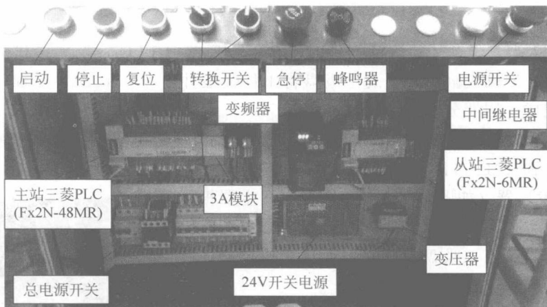
图 1-16 配电柜实物图
