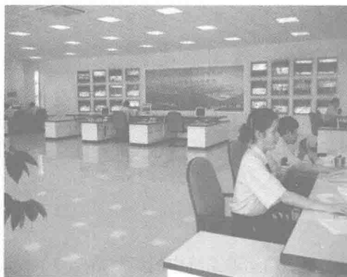
青岛 QQCT 控制室
