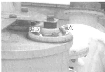
图 1-2 接地绝缘子外部漏点
