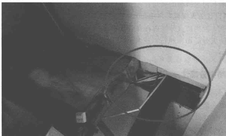
图 1-2 管道穿过防火隔墙的缝隙未封堵
