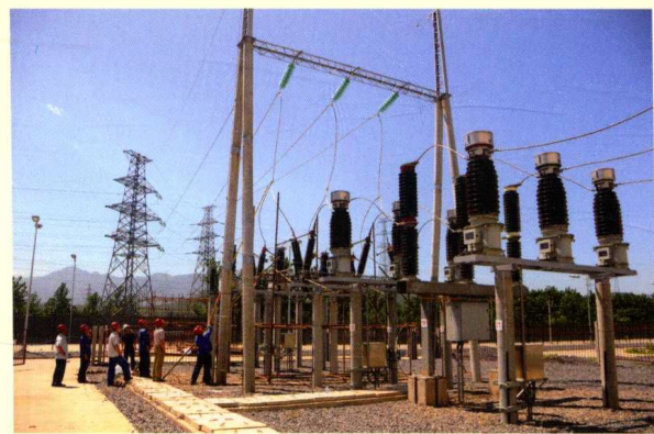
■ 快堆并网发电输电设备
